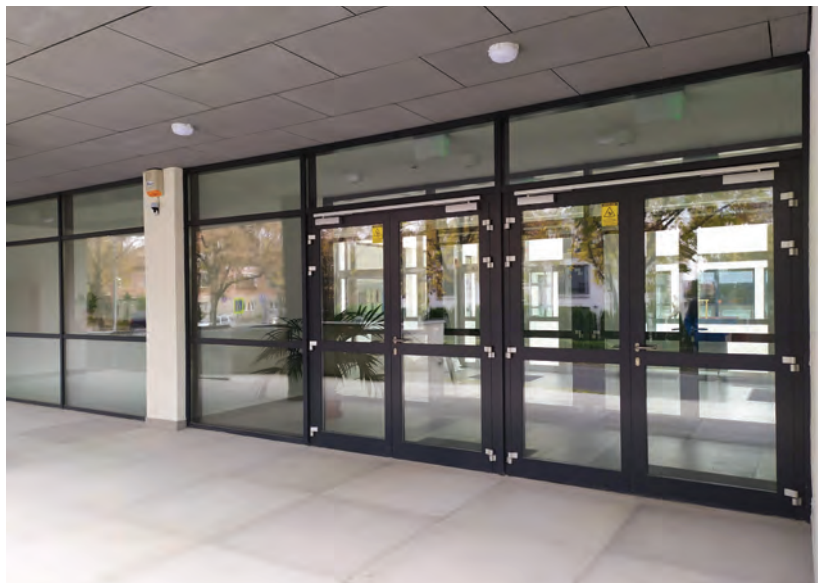
Hőhídmentes alumínium függönyfalba épített motoros légutánpótló bejárati ajtó Balatonfüred, Lóczy Lajos Gimnázium • 2020.
