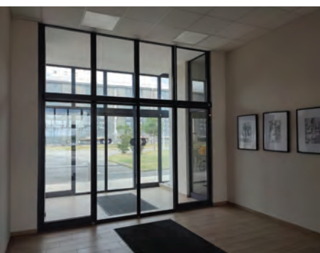
Alumínium szerkezetű bejárati portál automata ajtóval Inota • 2021.
